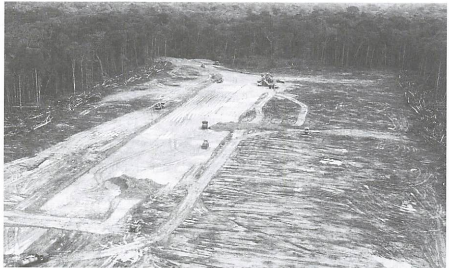
Für die Erschließung des Regenwaldes müssen für die Versorgung der Arbeiter Landepisten gebaut werden.
